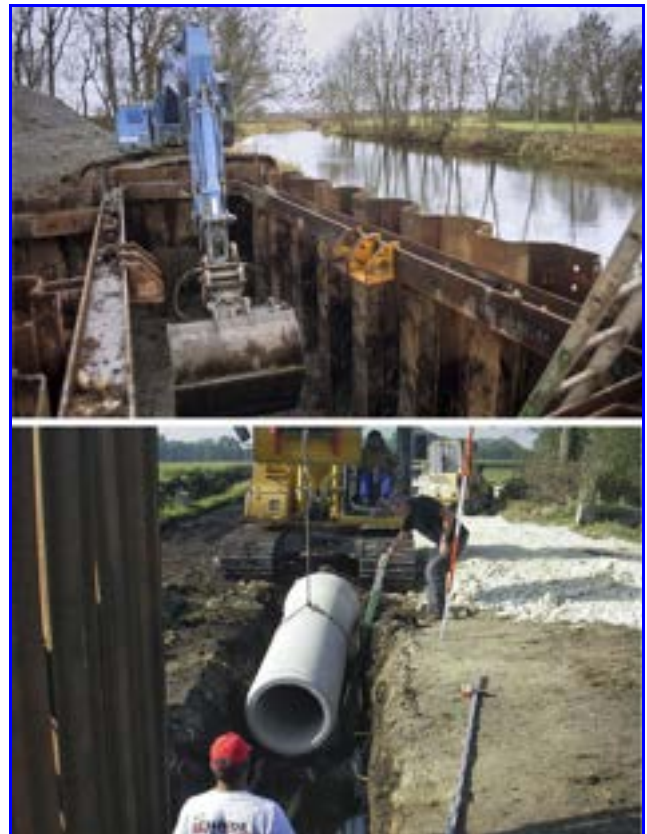
Abb. 15: Bau des Entnahmebauwerkes an der Nau und Verlegung der Rohre entlang des Grenzgrabens.
