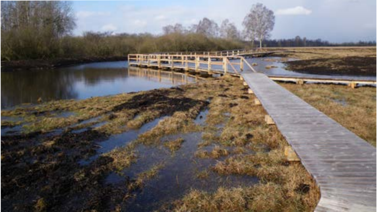
Der Höhepunkt der Leipheimer Erlebniswege - der „Bohlenweg“. Unten links im Bau und unten rechts das Ausschürfen der ehemaligen Torfstichbereiche.
