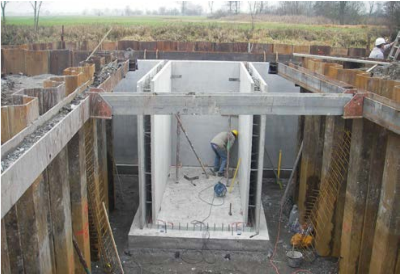
Bau der Nauleitung zur Wiedervernässung des Leipheimer Moores: Einlassbauwerk an der Nau ▲
