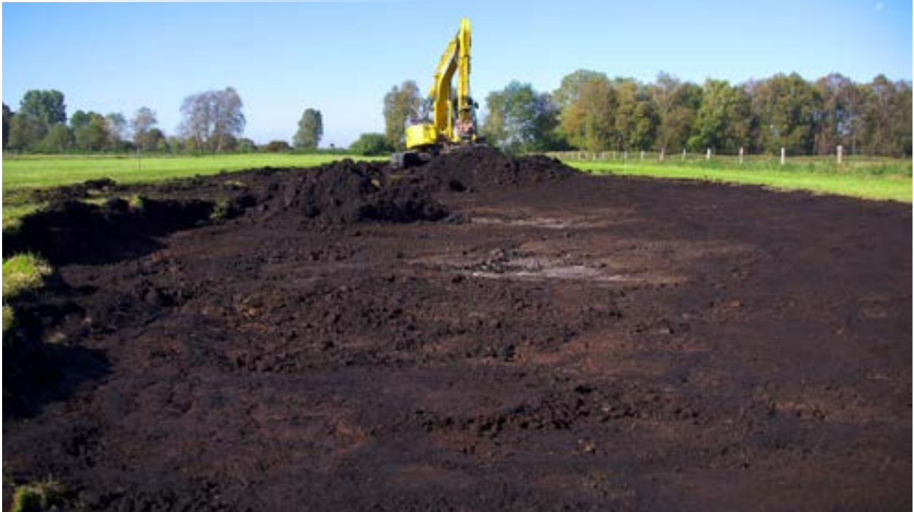
Im Rahmen des EU-Life-Projektes wurden in 2010 umfangreiche Lebensraumverbesserungen, insbesondere Bau von Flachmulden und Abflachung von Grabenstrecken in Wiesenbrüter-Schwerpunktgebieten durchgeführt.
